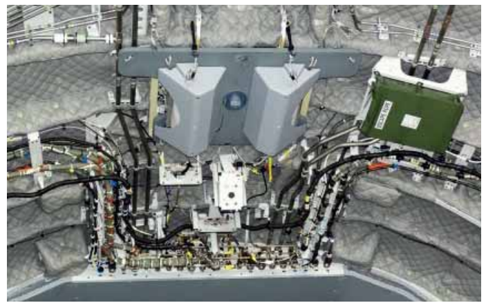
Die Verkabelung sowie die Hydraulikleitungen sind im hinteren Bereich des Laderaums gut sichtbar. Hier können die Kabelführung und die Steckverbindungen gut überprüft werden.
